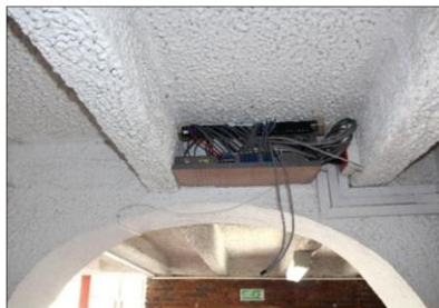
Cableado de internet
