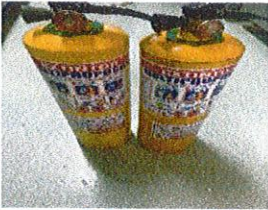
Imagen 9. Recarga extintores Fuente Bienestar
