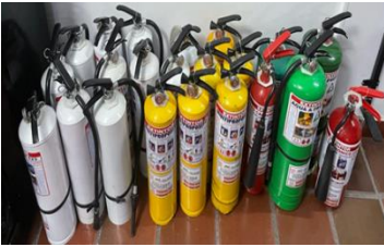
Imagen 5 Recarga extintores Fuente
