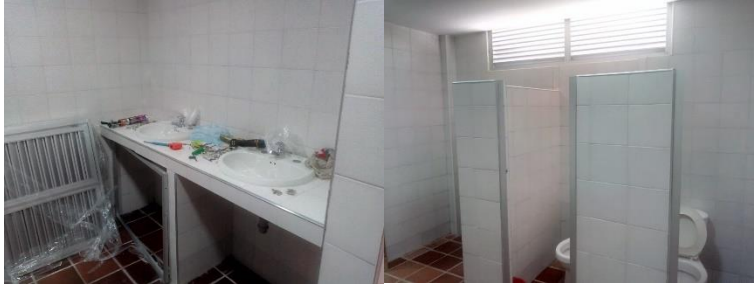
Imagen 18. Baterías de baño piso 2 remodelado
